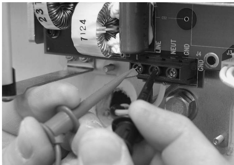
Рисунок 23 Проверка входящего напряжения и на линейном входе
